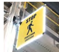
Señales de Seguridad con LED
